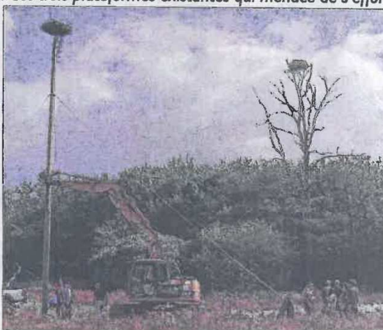
Pour remplacer la plateforme installée en 1997 sur la cime d'un arbre mort, un pylône de 15 m de haut a été érigé pour accueillir des balbuzards pêcheurs.
